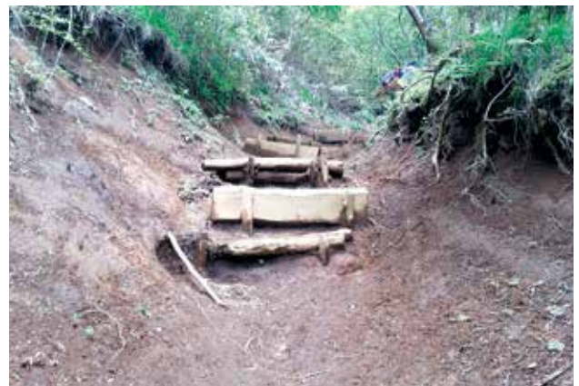
浸食が深くなり今にも崩れそうな階段
