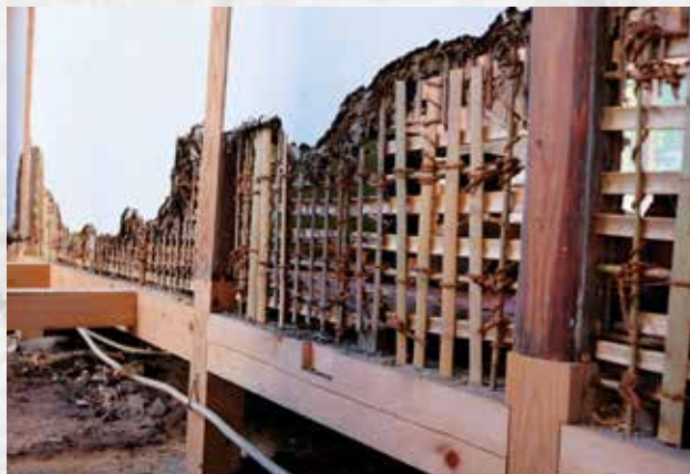
上／改修前の茶亭 中／柱や土台は経年による老朽化だけでなく地面に触れることで腐食していた。 下／刷新した部分と古い材が入り混じる。
