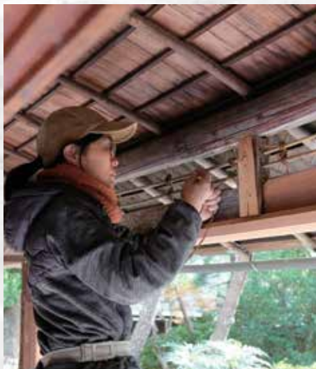
建物の歪みを直した際に崩れ落ちた土壁は、再び竹小舞を編んで修復。
